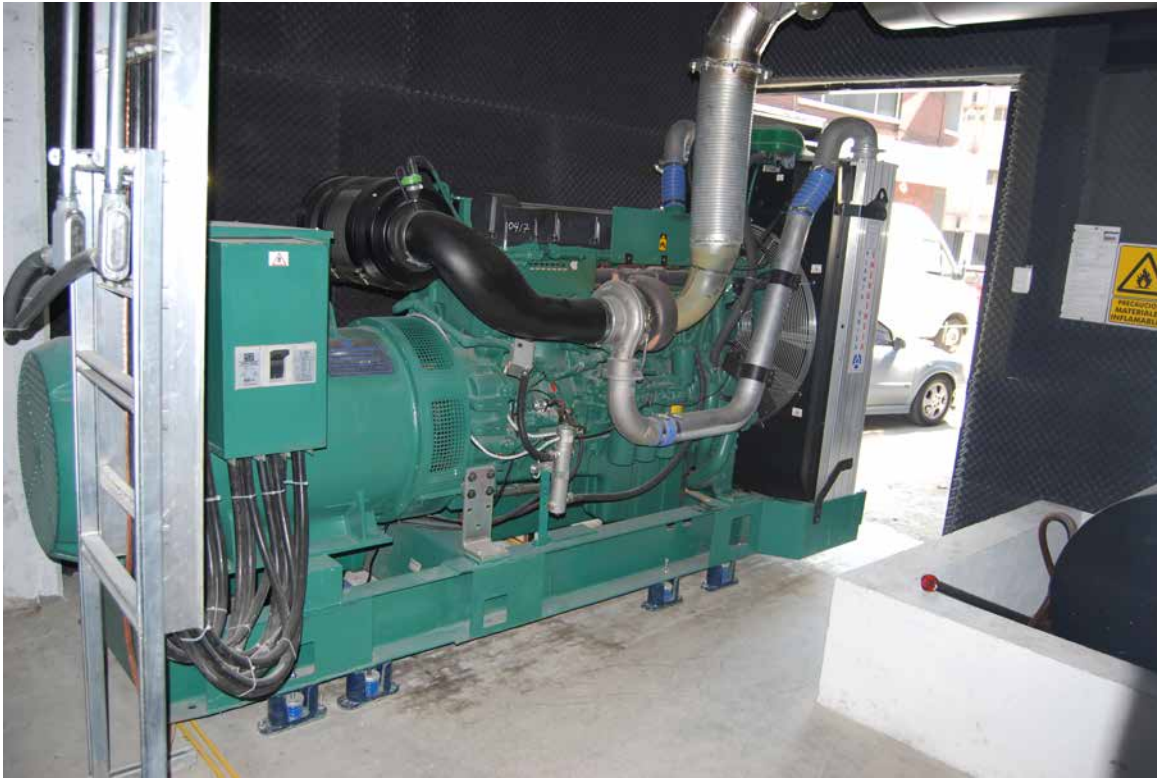
Unidad de generación eléctrica a base de motor recíprocante diesel .6 Mwe.
