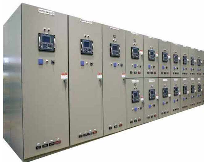
Switchgear Media Tensión.
